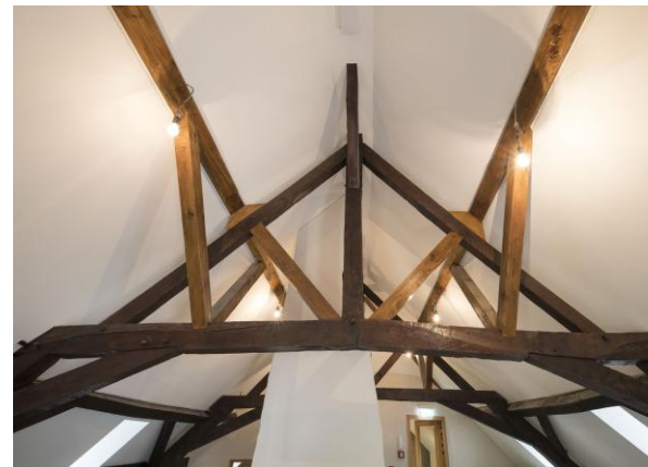
Altes Dachgesperre bleibt sichtbar trotz Dämmung Dachfläche
